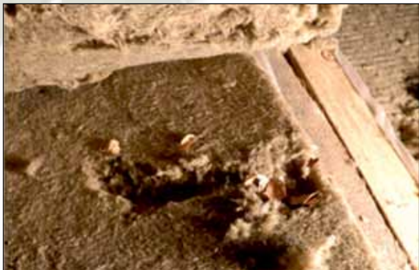
Норы мыши-полевки в минеральной вате чердачного перекрытия второго этажа загородного дома.
